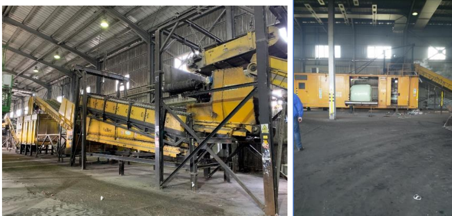
Figura 4-11 Stația de sortare Timișoara (linia de valorificare energetică)
