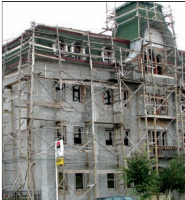
Construcție neterminată de doi ani- Centrul Lovrinului
